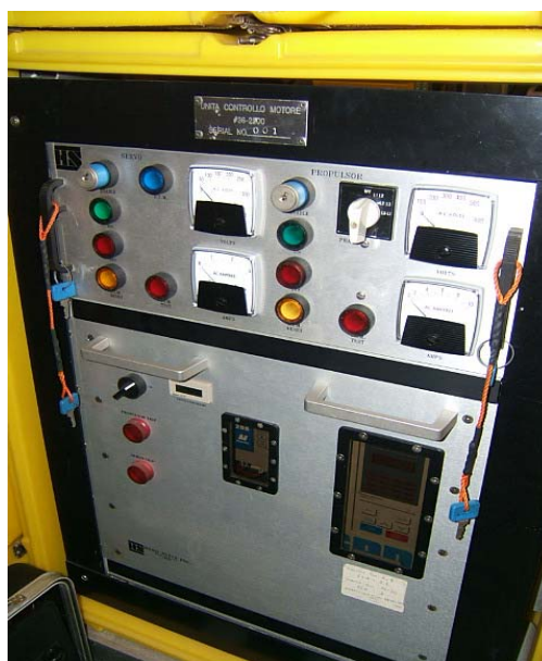
(pannello alimentazione 440V. - 400Hz)
